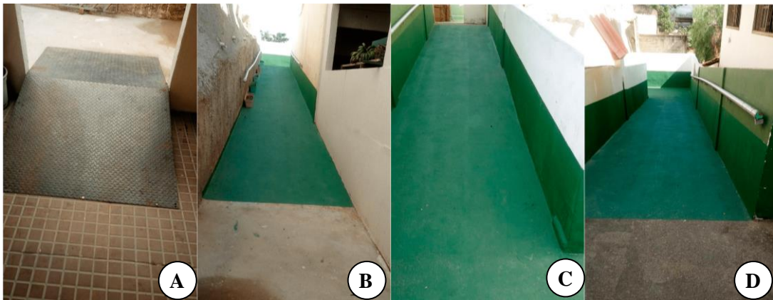
Figura 31: Acesso à rampa (A), rampa de acesso ao 1º pavimento (B, C e D)
